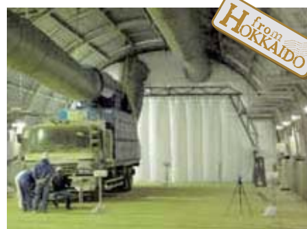
■トラベルクリーンカーテンの設置状況
