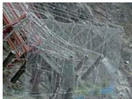
■金網衝突部に設置された高エネルギー吸収ロープ
